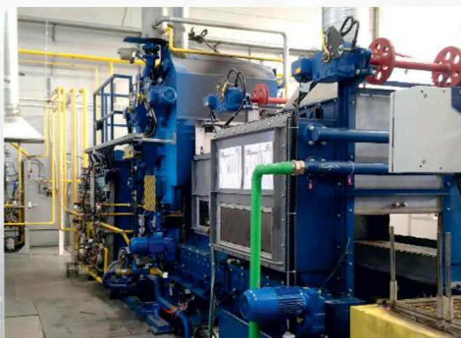
Линия термообработки после проведения гарантийных испытаний
