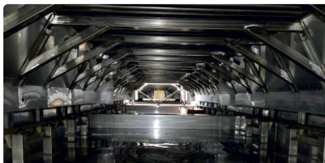
Внутреннее пространство печи
