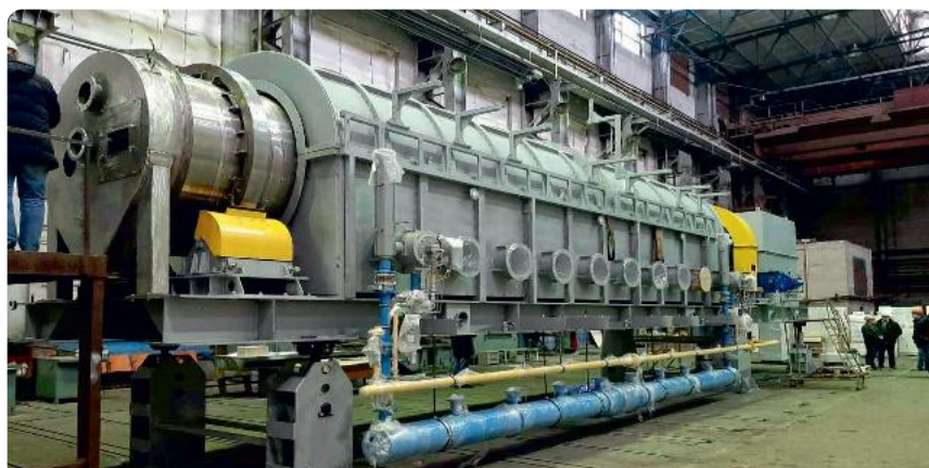
Общий вид печи
