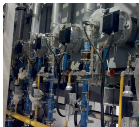
Узел установки рекуперативной горелки
